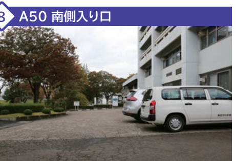
縦横が急な傾斜になっていることに加え、地面にひび割れもあるため、注意してください。
