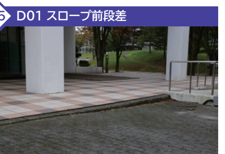
スロープの手前部分は段差が大きく、気づきづらいため、注意してください。
