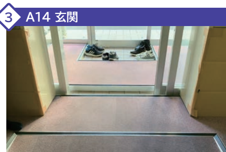
入り口はスロープがありますが、玄関に靴を着脱するための段差があります。
