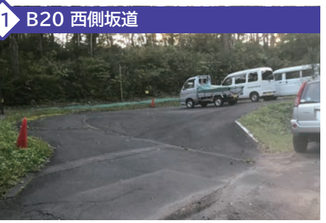
急な傾斜に加え、地面にひび割れもあるため、転倒に注意してください。
