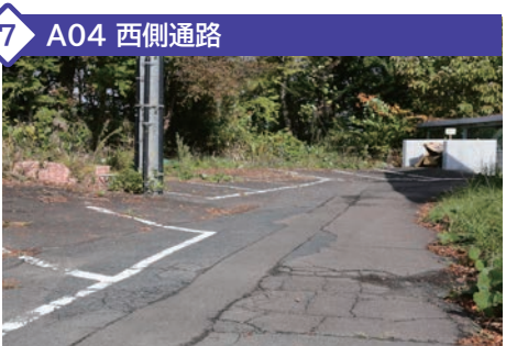
傾斜に加え、通路にひび割れがあるため、注意してください。
